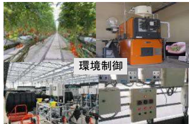
統合環境制御装置
