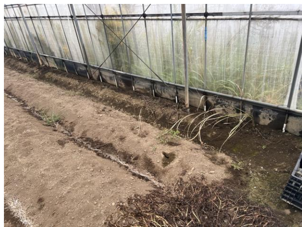
止水シートをくぐって侵入する水
