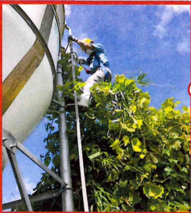
タンクの近くに木々があり危険
