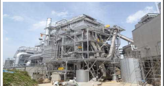
畜ふんボイラー : 南国興産(株) (2号機)
