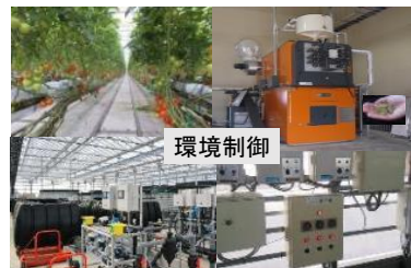
統合環境制御装置
