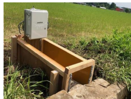
自動開閉水門
