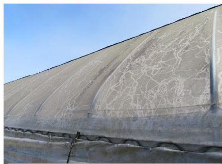
灰が積もった被覆施設
