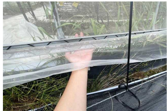
写真6 防虫ネットの隙間
