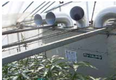
ヒートポンプの活用
