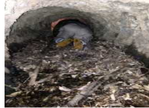
水路トンネル被災状況
