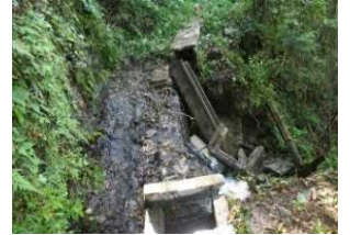
用水路被災状況
