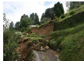
農道被災状況
